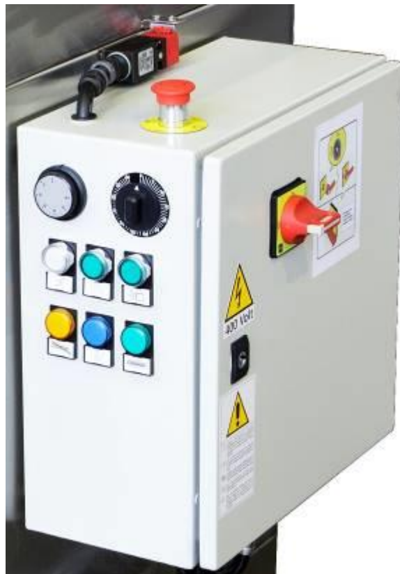
Cuadro eléctrico con final de carrera de la tapa y paro de emergencia
